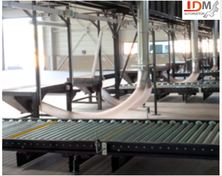
Lignes de stockage automatiques piles de palettes vides
